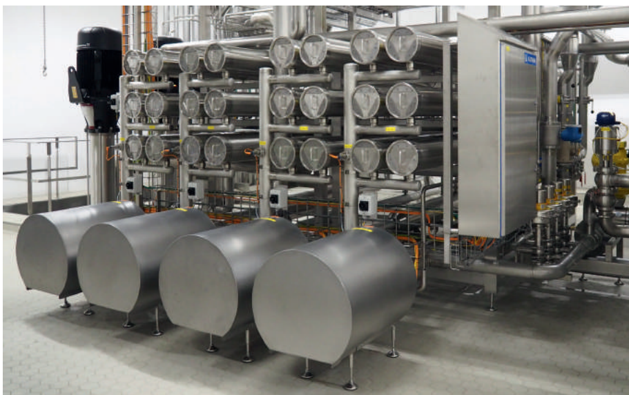
Das Herzstück des Fonterra-Projekts ist eine neue ALPMA RO HighTS Anlage (Foto: mi)
