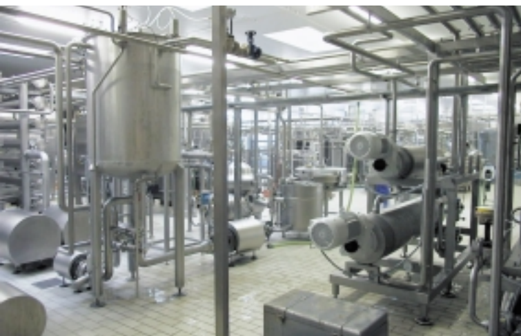
Abbildung 4: Produktionsanlage zur Partikulierung von Molkenprotein (Engineering, Anlagenbau und Inbetriebnahme durch LTH Dresden)
