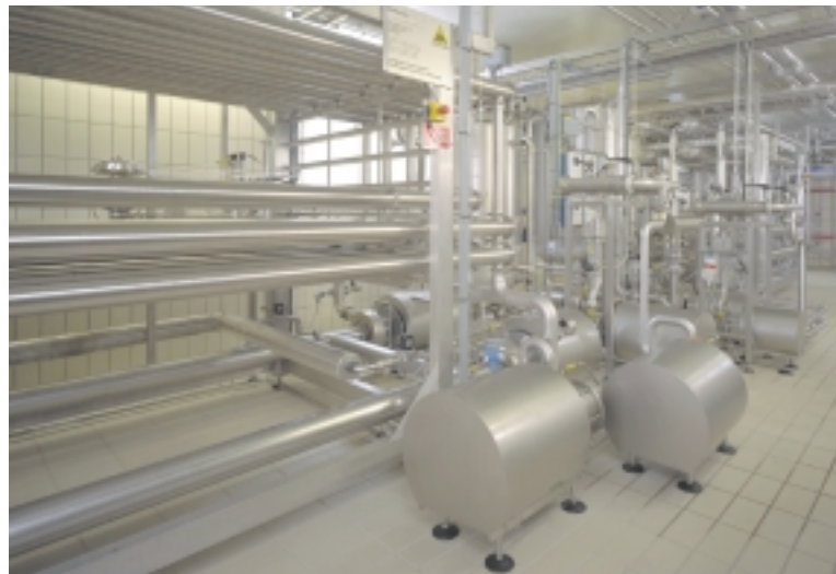
Kombinierte UF-/NF-Anlage zur Molkenverarbeitung
